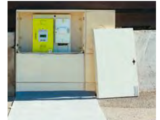
Coffret basse tension
