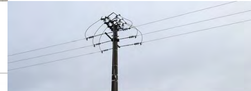
Lignes HTA (moyenne tension) aériennes ou souterraines
